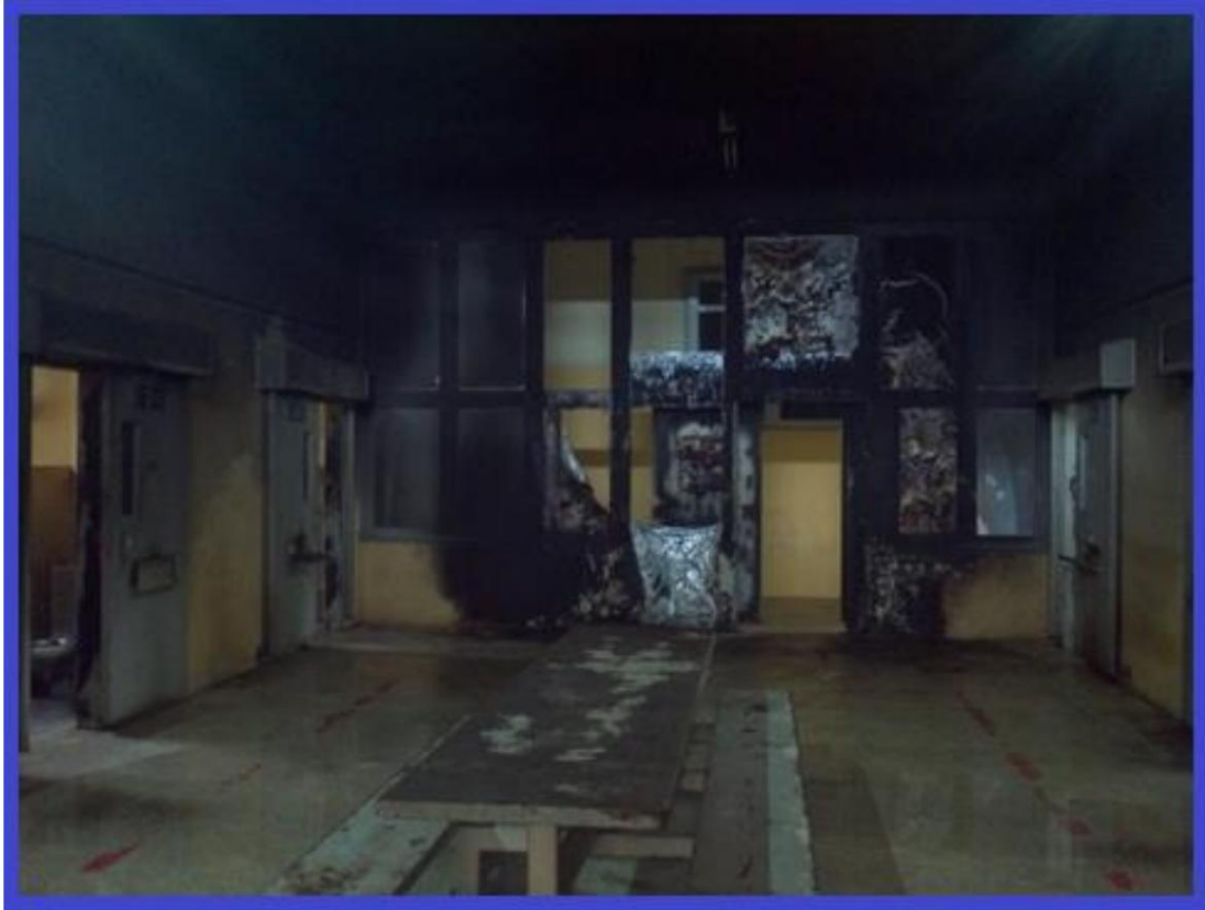
Imagen 10 – Galería “D” del PEVV-I después del incendio
