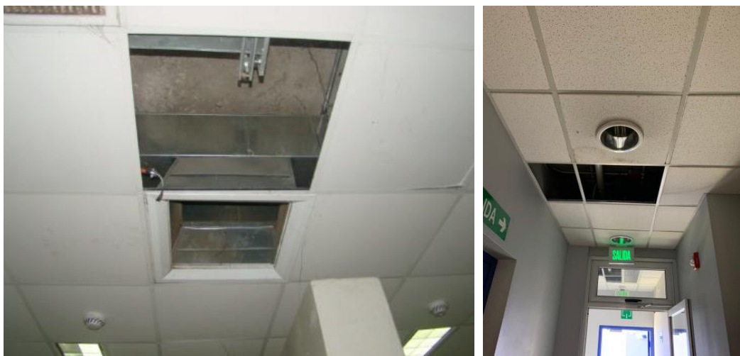
Fotografías: Láminas del cielo raso desprendidas en las delegaciones policiales de la Fuerza Pública de Pérez Zeledón (izquierda) y Guararí (derecha).
