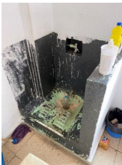
Detalle de la placa turca de una de las celdas del CP Puerto I (Cádiz)
