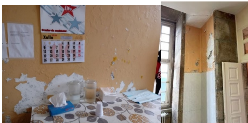
Detalle de la humedad existente en algunos espacios del Hospital Psiquiátrico de Conxo
