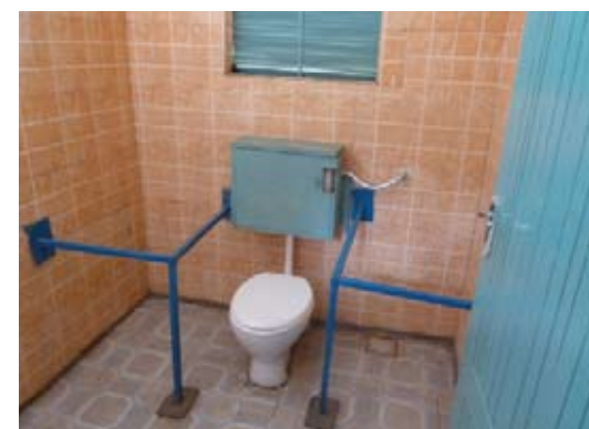
Un retrete diseñado para usuarios con discapacidad en una instalación de saneamiento pública construida por la Compañía de Aguas y Alcantarillado de Nanyuki, en Kenya. FOTOGRAFÍA: EDWAR D KUNG'U, ARQUITECTO DEL WSTF
