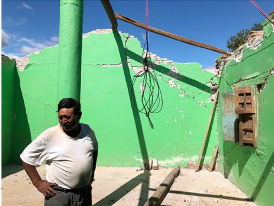
Daños en la vivienda tradicional de Ixtepec, Oaxaca
