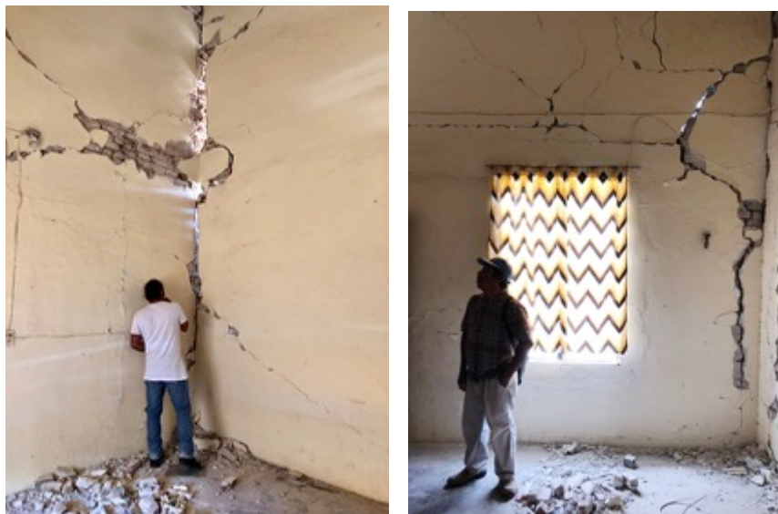
Análisis de daños en vivienda tradicional.
