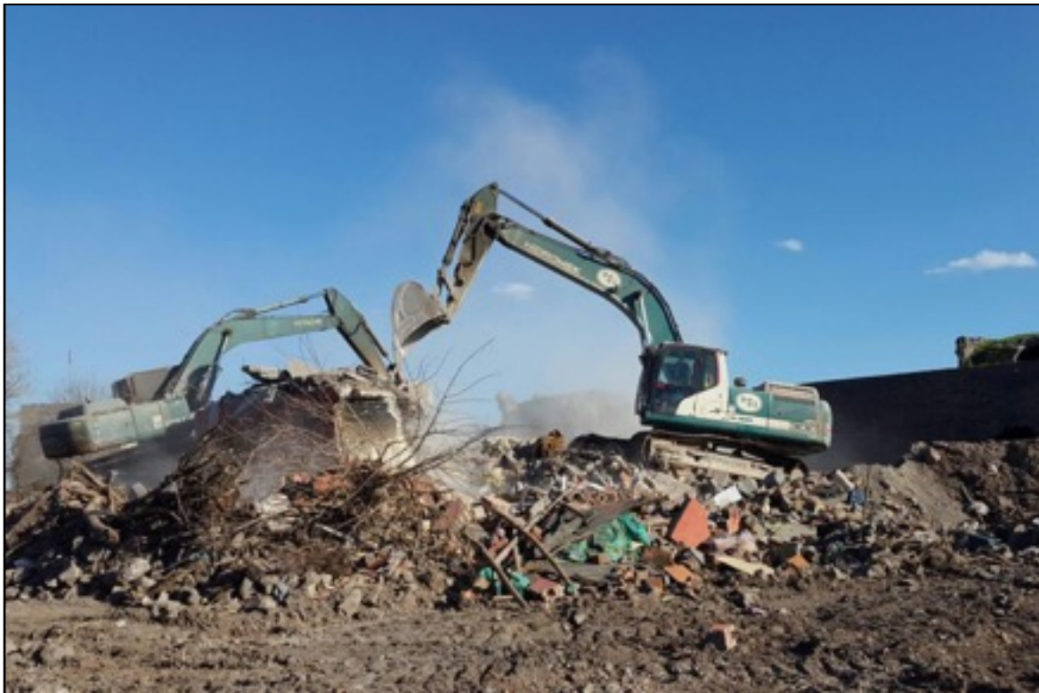
PHOTO 8- DESCTRUTION IN SUR
