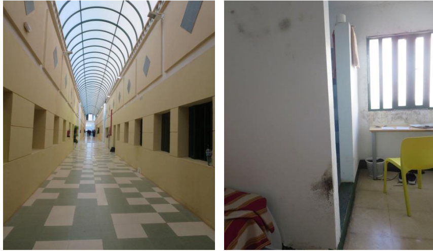
Pasillo y habitación con humedades del CIMI Ciudad de Melilla
