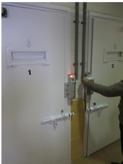
Apertura de puertas por aproximación de tarjeta
