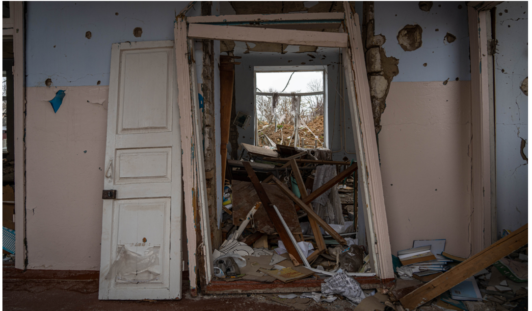
Зруйнована школа в селі Архангельське (Херсонська область).
